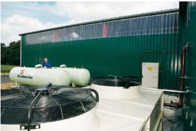
»» Mehrere große Biogasanlagen wurden in der Phase der Inbetriebnahme mit den nötigen hohen Energiemengen von Westfalengas versorgt.
